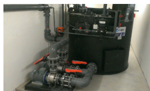
Neutralisation effluents laboratoire par injection CO2 et Soude
