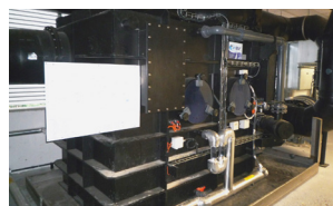
Laveur de gaz traitement COV aspirations process
